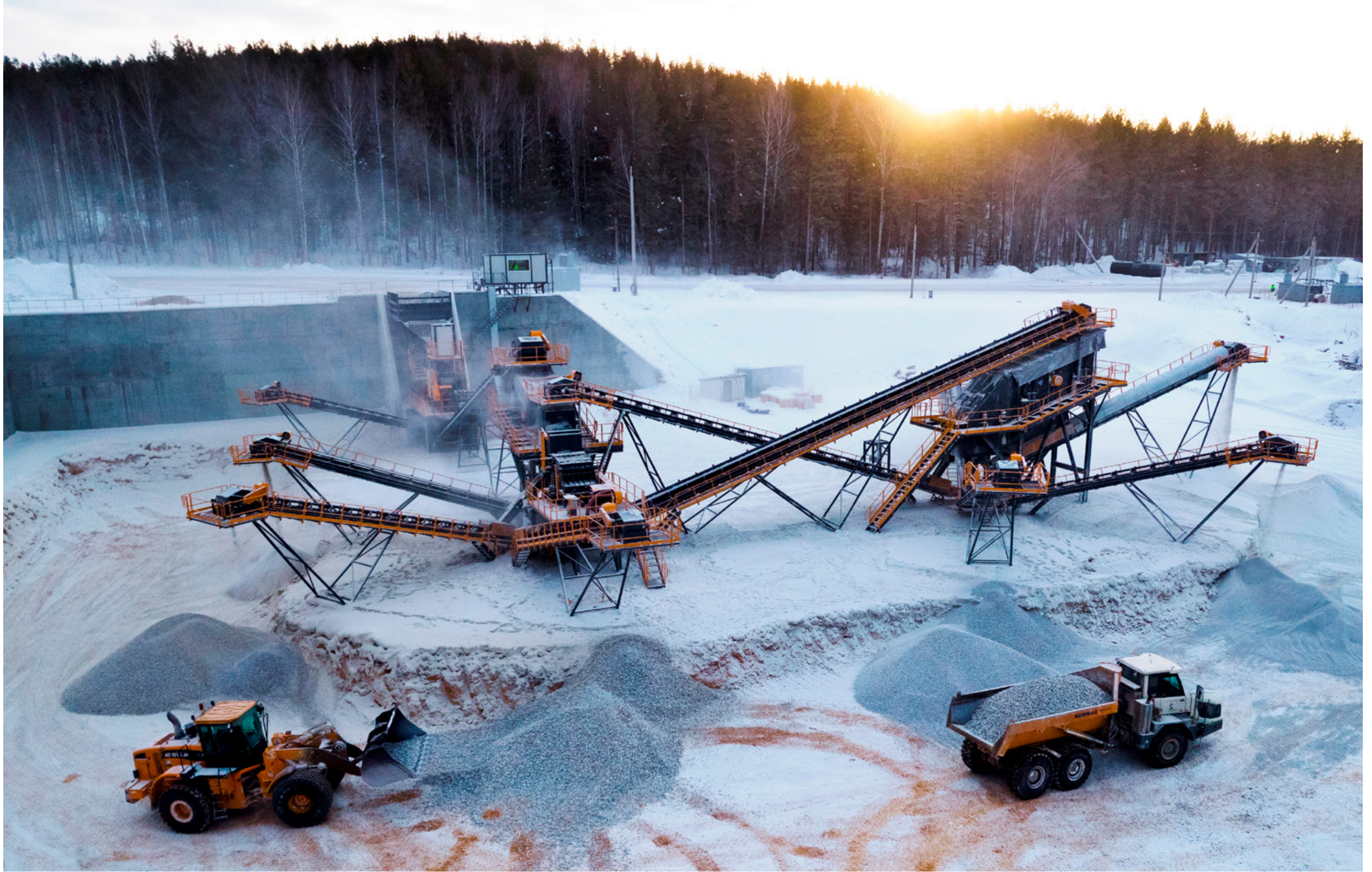
▲ MEKA Agregat Üretim Tesisi Rusya
