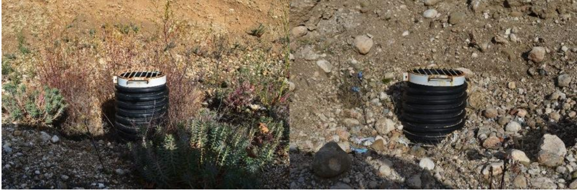
Regülatör-Yükleme havuzu arasındaki korige borunun havalandırma menfezleri
