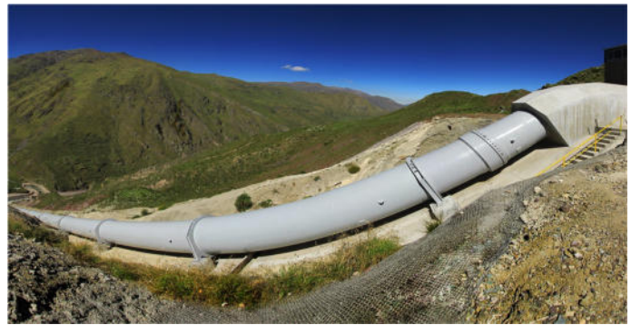
Çukurçay HES Cebri Boru Hattı
