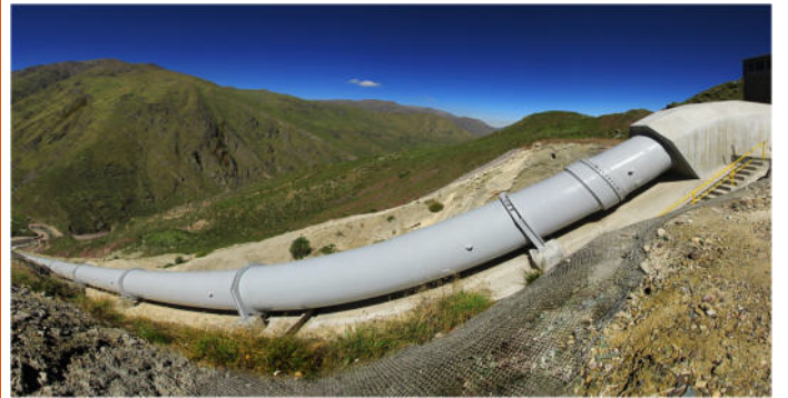
Çukurçay HES Cebri Boru Hattı
