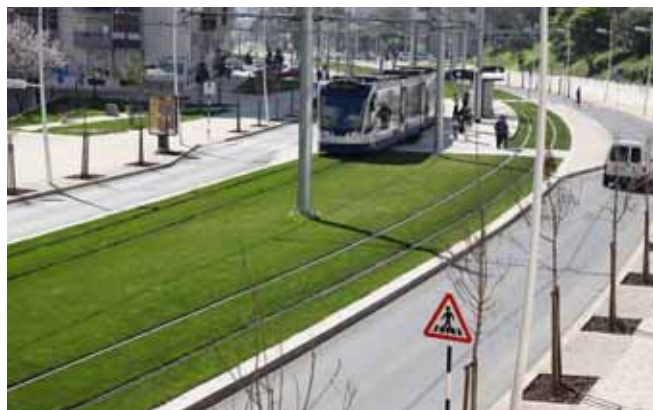
50 MST(ACE)/Siemens / Instalação de Via-férrea e de Catenária na Linha do Metro Sul do Tejo
