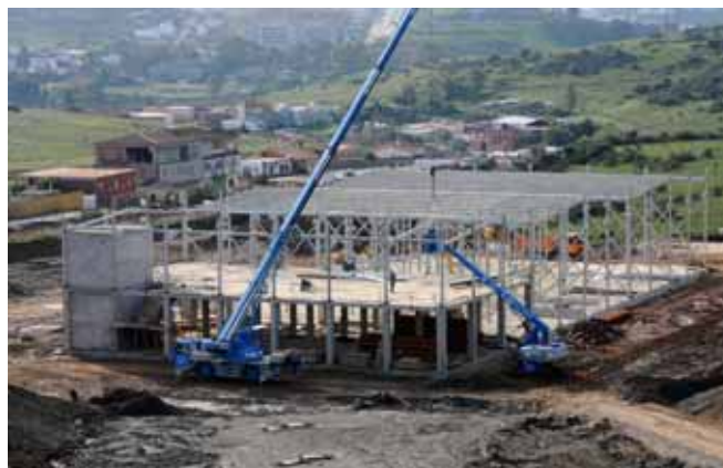
71 Algesa / Instalações para os Serviços de Recolha de Resíduos e Limpeza / Algeciras
