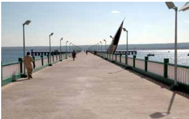
75 Ministério dos Transportes e Comunicações / Reabilitação e Construção das Pontes Cais de Inhambane e Maxixe, na Província de Inhambane
