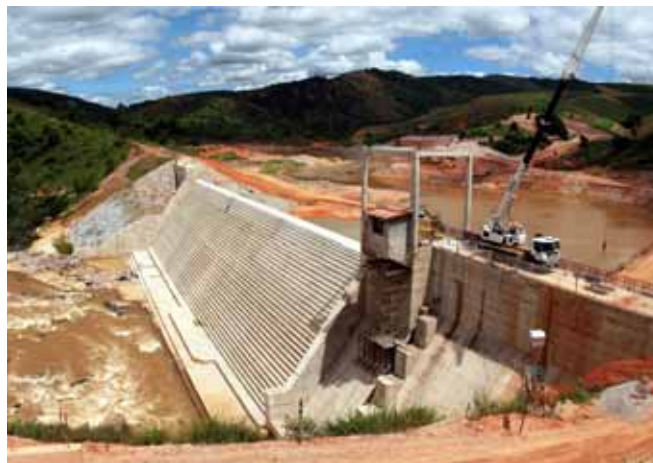
69 Pequena Central Hidroeléctrica da Areia Branca
