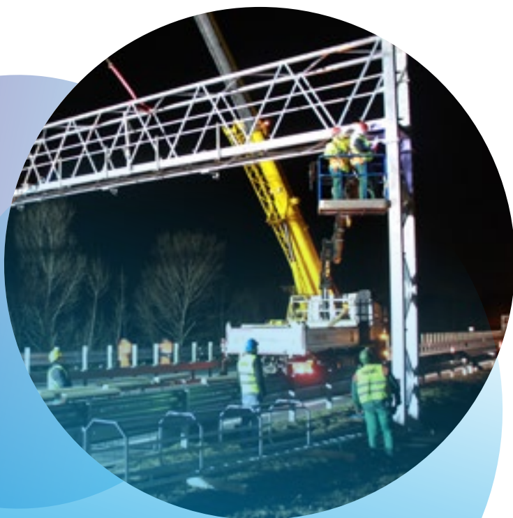
Postavitev enega od cestninskih portalov v okviru projekta E-cestninjenje.
