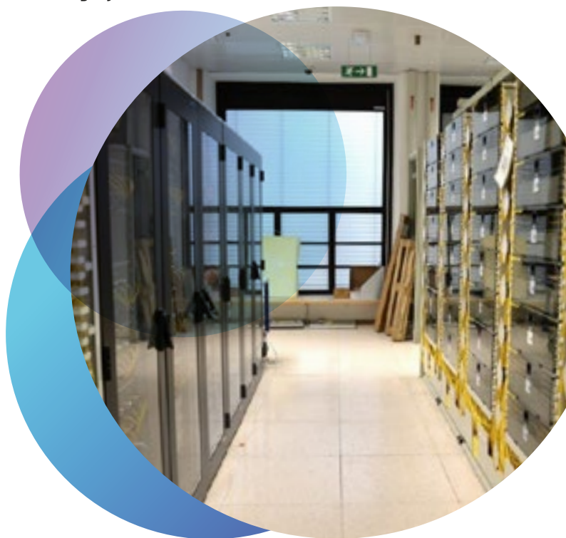
Na fotografiji je podatkovni center Telekoma Slovenije.
