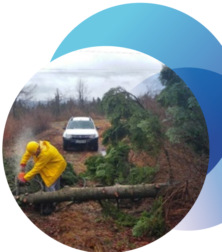
Odpravljanje škode na kabelskih povezavah
