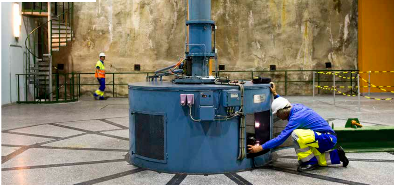
Maskinsalen vid Holmens vattenkraftverk i centrala Norrköping.
