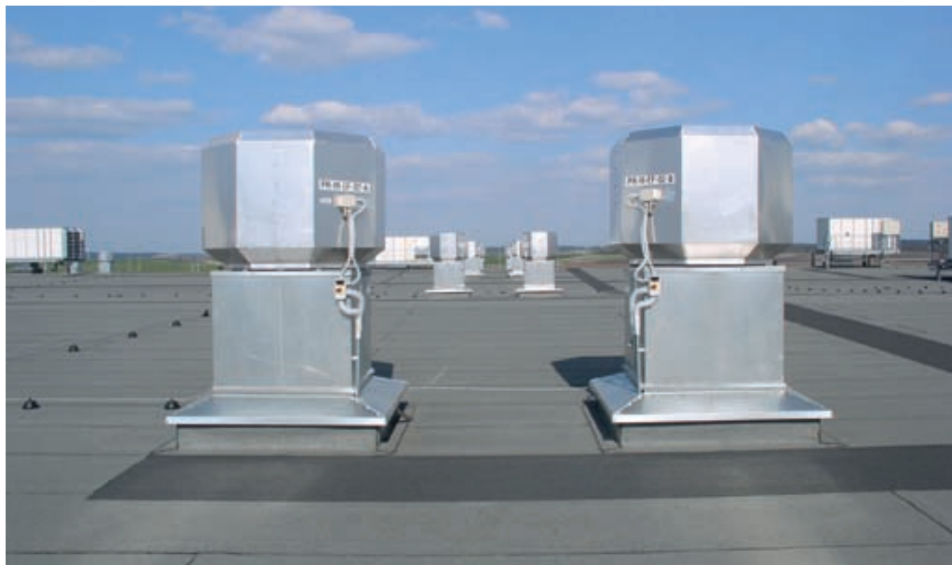
Systemair har levererat brandgasfläktar till Skodas fabrik i Kolin, Tjeckien.
