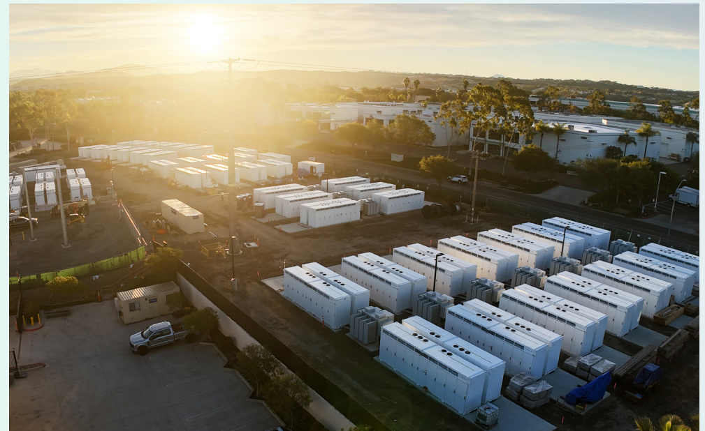
Batterilagerprojektet Pome omfattar 100 MW och ligger i San Diego County i Kalifornien.
