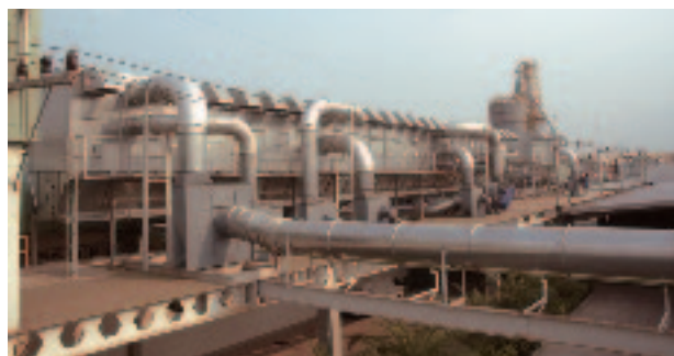
Ovan och till höger: Filteranläggning från Dantherm Filtration installerad i en trägolvfabrik i Thailand
