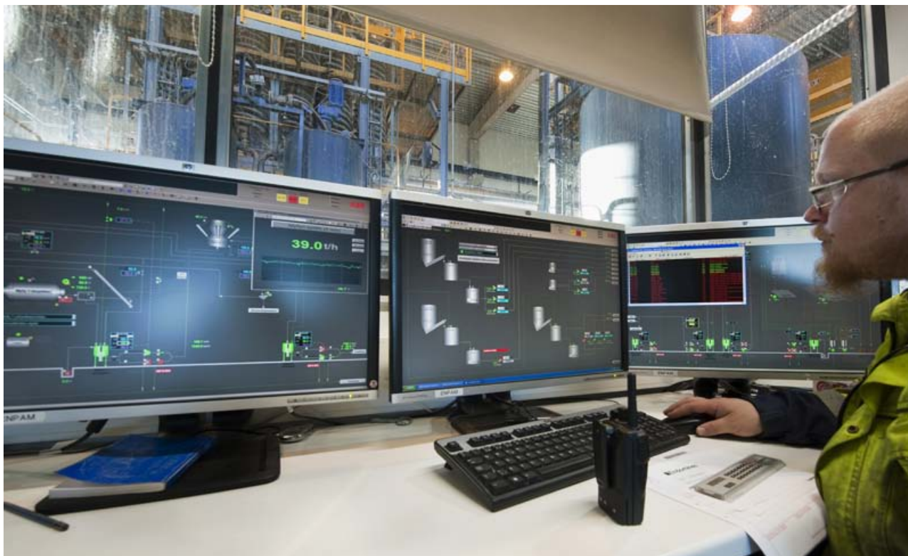
Produktionsövervakning från kontrollrummet.
