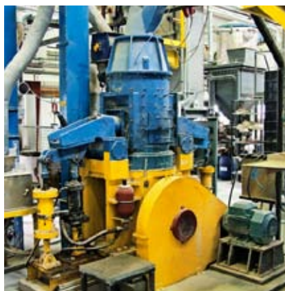
FLSmidth forsøgsanlæg til cementformaling
