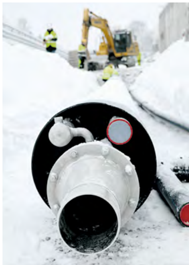
Kortreist og innovativt varmeopptak På Myrvoll Stasjon gjenvinnes varme fra avløpsvannet i et spesiallaget rør.
