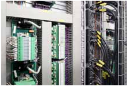
Multitechnieken - Algemene &amp; industriële elektriciteit
