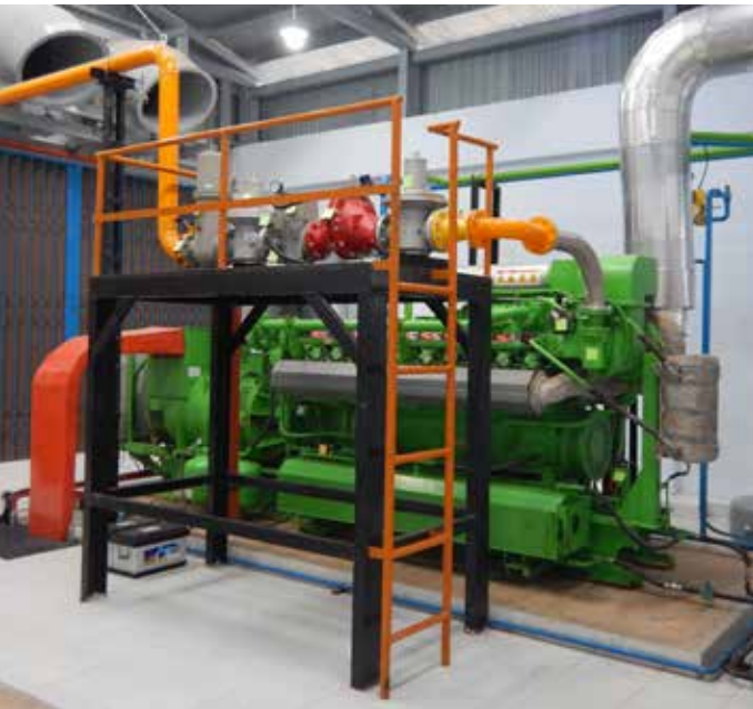
Biogasmotor in Mukomuko
