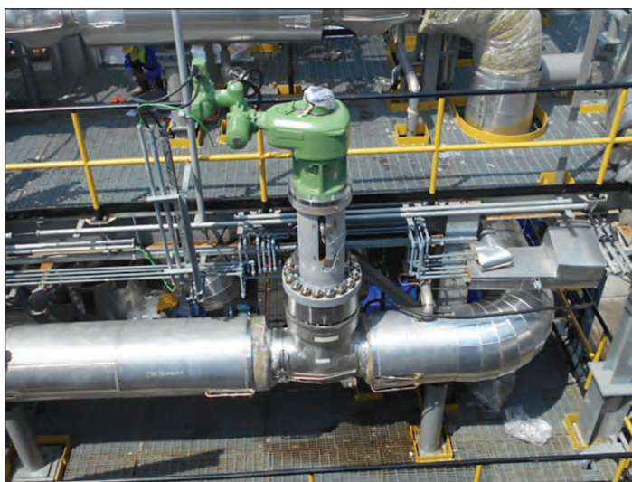
Robinet-vanne Velan en acier forgé 16" classe 2500 pour service hydrogène à haute température et haute pression installé dans un processus AXENS-HYVAHL sur le site d'RPC Rayong en Thaïlande.
