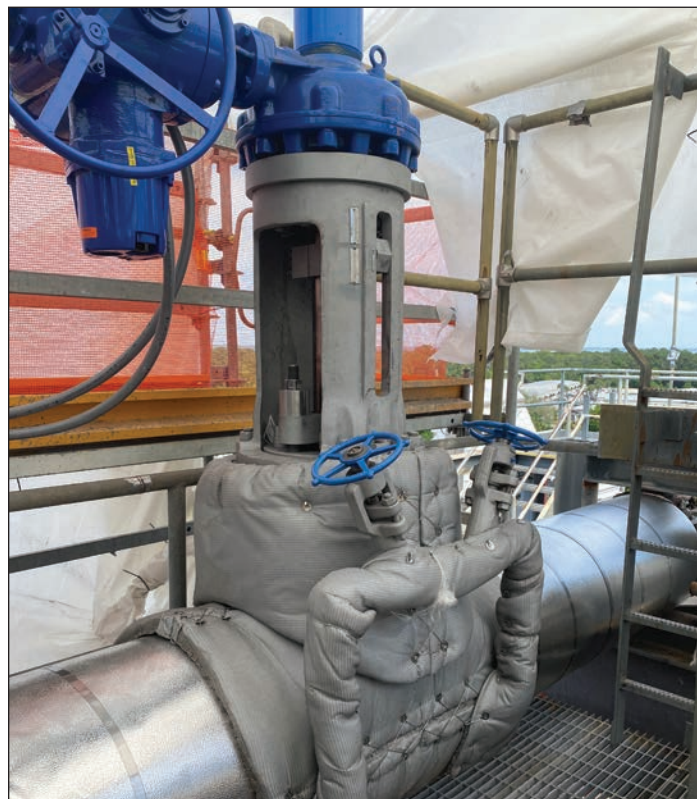
Cette robinet-vanne autoclave en acier forge de 14 pouces de classe 2500, installée dans une centrale électrique en Floride, fait partie d'un important contrat à long terme avec Velan pour la fourniture de plus de 100 vannes (12 à 24 pouces) sur 5 ans.
