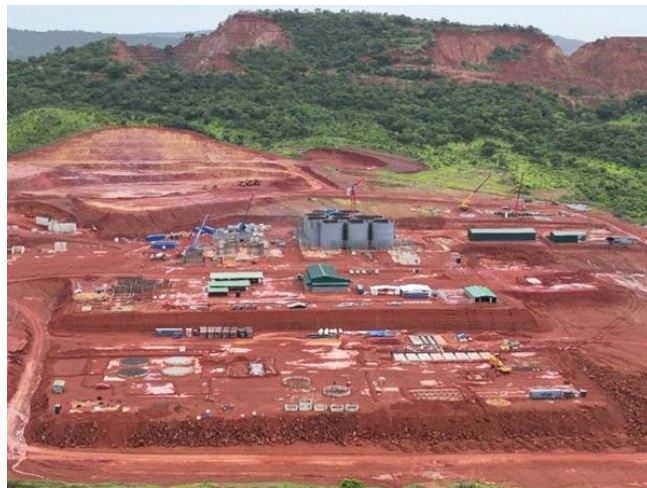
Figure 8 : Vue aérienne de l'usine de traitement et des infrastructures
