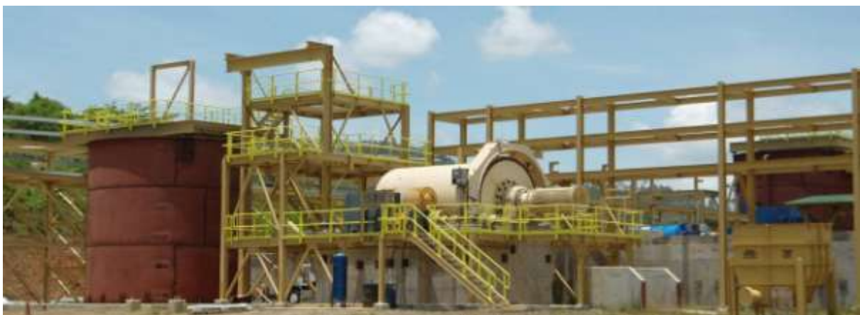
Las Lagunas - Ball Mill and Piperack
