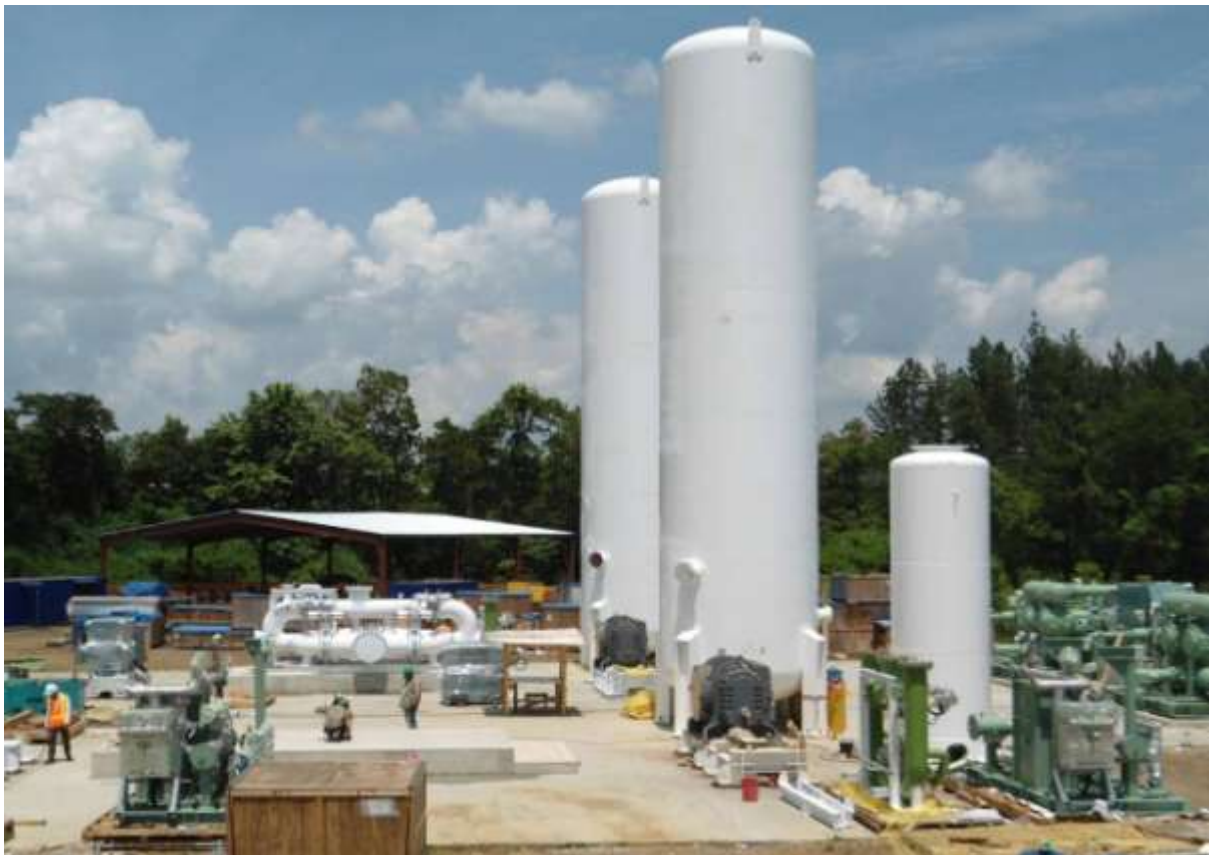
Las Lagunas - Oxygen Plant
