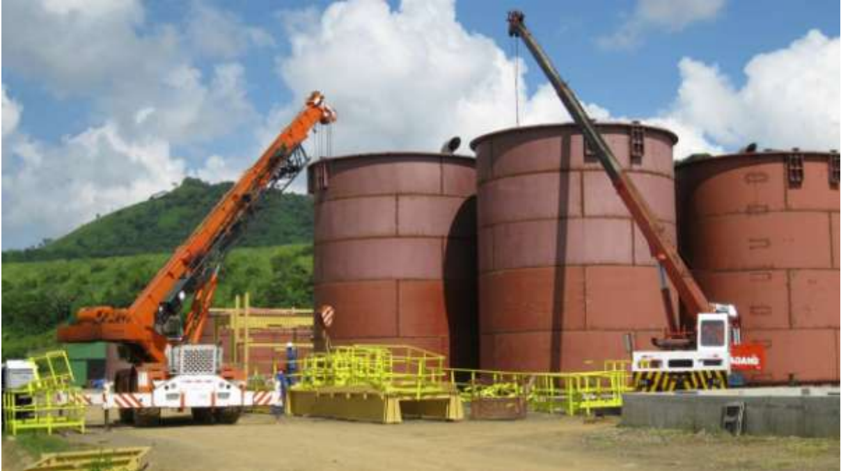
Las Lagunas - CIL Tanks
