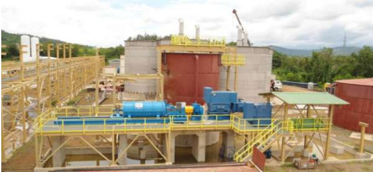
Las Lagunas - IsaMill & Oxidation Tanks
