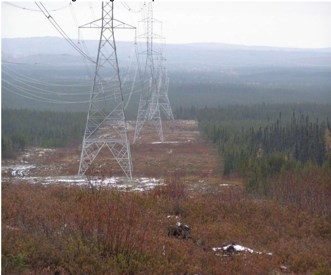
Figure 6 - Ligne électrique au site Rose lithium-tantale
