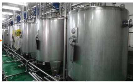
緩衝罐（暫存罐）
