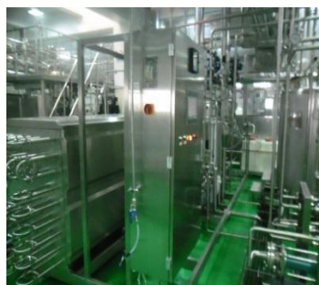
實驗工廠試生產及 生產參數確認
