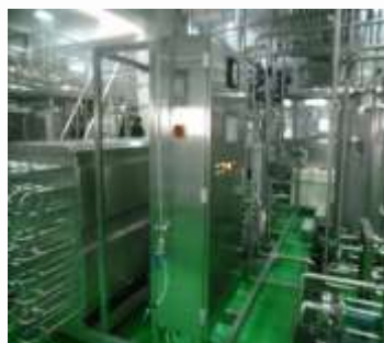
實驗工廠試生產及 生產參數確認
