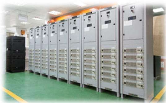
1. 通訊電源系統(SMR)
