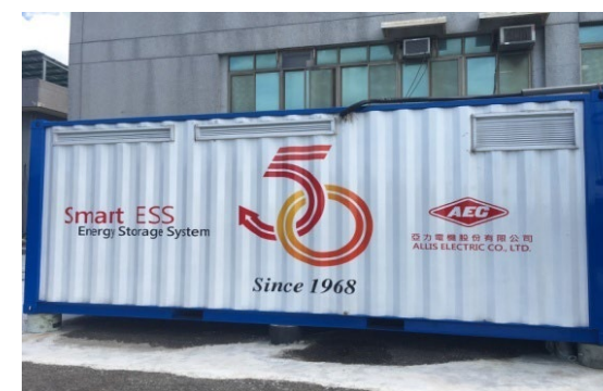
6. 微電網 光/儲能系統 及相關設備
