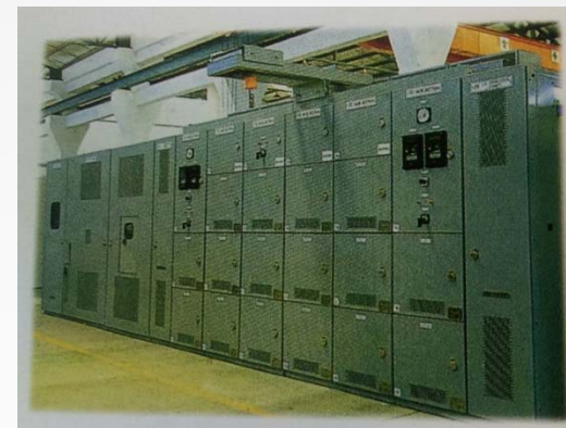
480V電力配電中心(Power Center)
