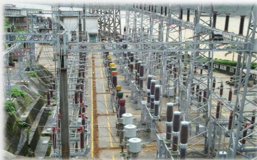
傳統式戶外變電所
