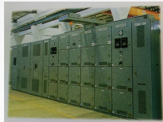
480V電力配電中心(Power Center)
