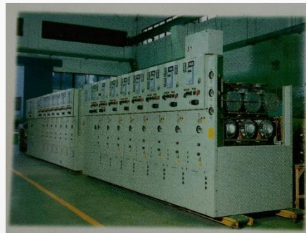
23kV SF6氣體絕緣開關(G. I. S)
