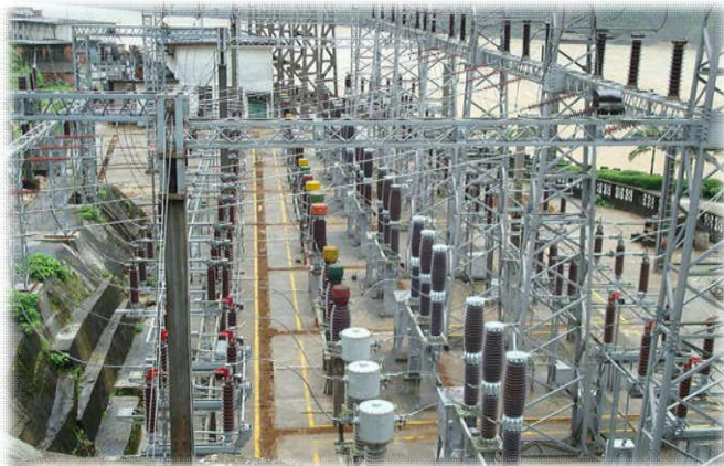
傳統式戶外變電所
