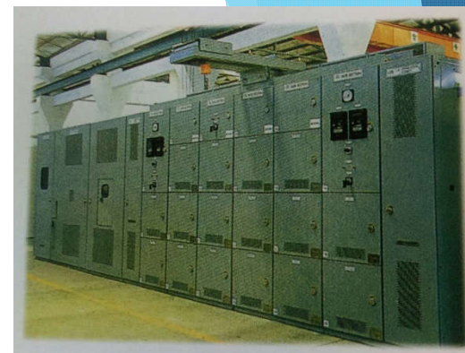
480V電力配電中心(Power Center)
