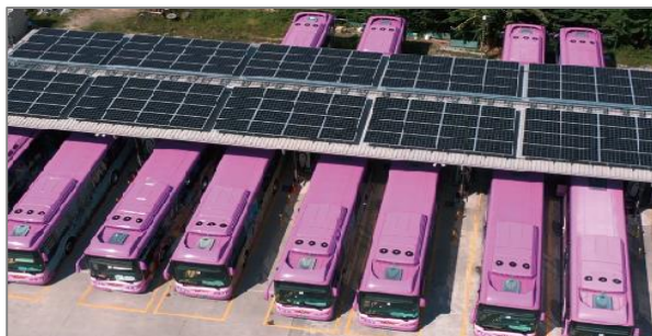
太陽能發電系統
