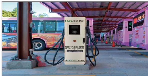
OCPP 120 kW充電機
