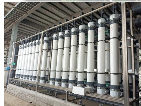
UF membrane system
