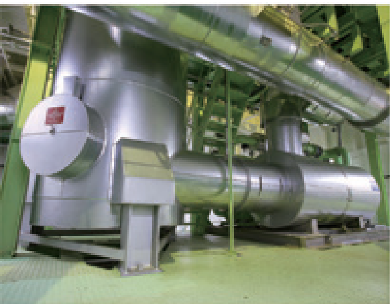
▲氮氧化物觸媒轉換設備
