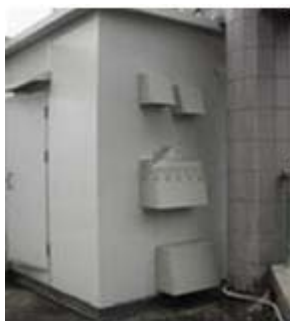
基站空調室外機
