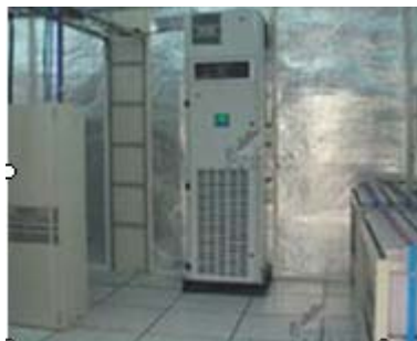
基站空調室內機
