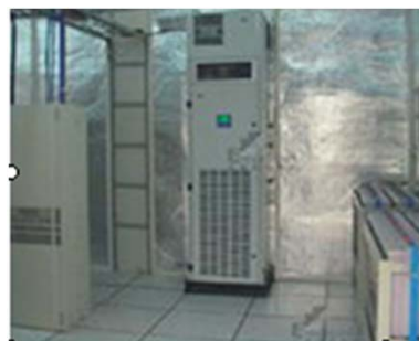
基站空調室內機
