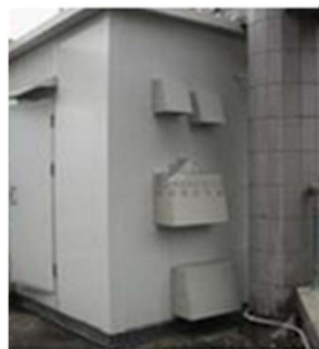
基站空調室外機
