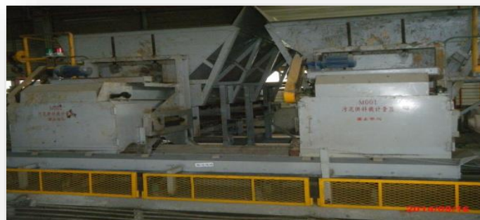
▶ 污泥供料機計量器
