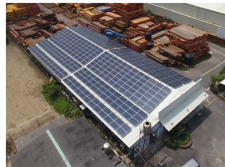
和宏(高雄) 120kWp
