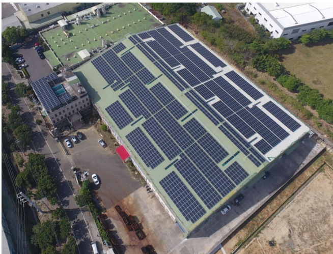
進興(嘉義) 749kWp
