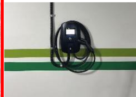
綠能社區智慧充電與能源管理
