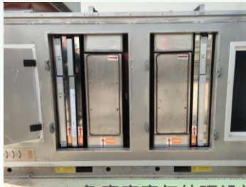
★ 危废库废气处理设施
