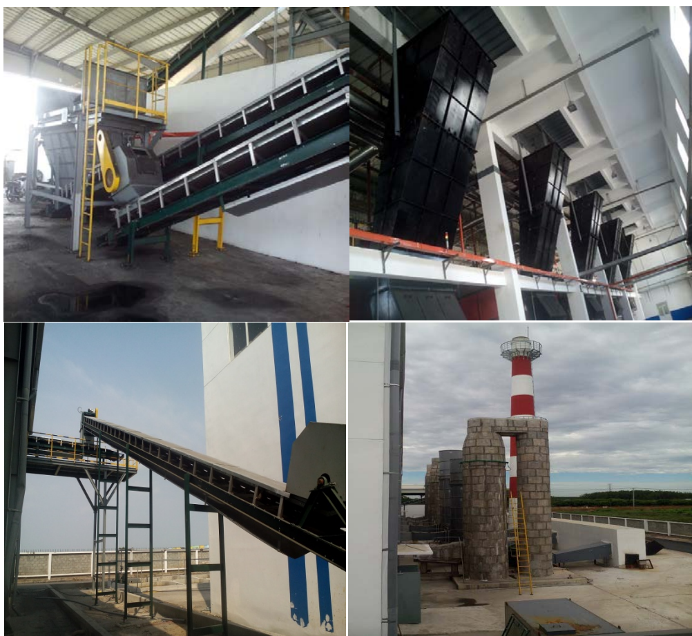
图 54 锅炉系统及烟气的处理
