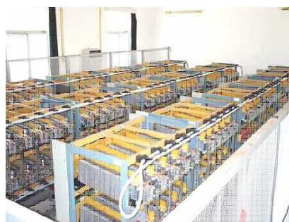
SVC 的晶闸管变流阀组
