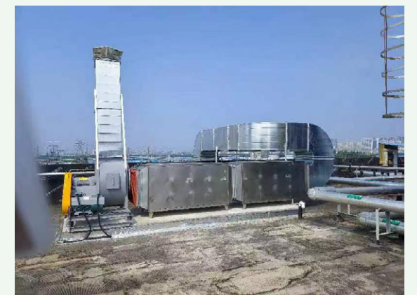
新增热处理废气净化装置
