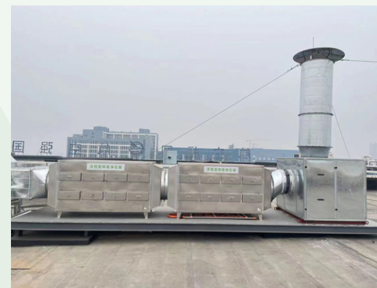
新增VOC废气净化装置
