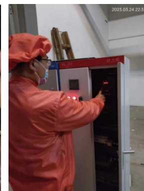
运行人员现场操作
