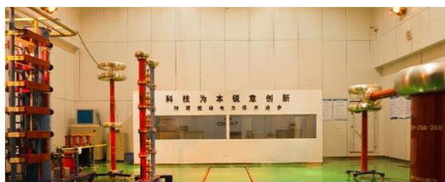
全屏蔽试验站 (雷电冲击试验、局部放电测试)
