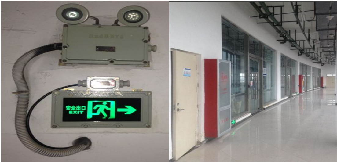
佰利联安装先进的防爆应急灯和消防设施
