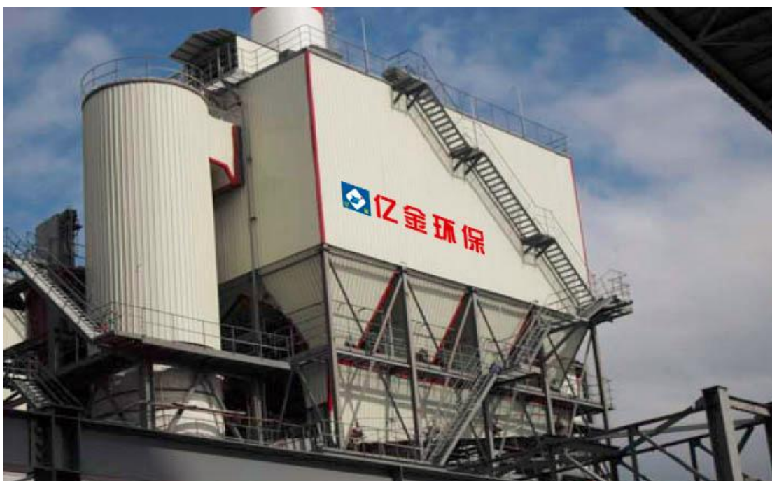
循环流化床烟气脱硫设备实景图
