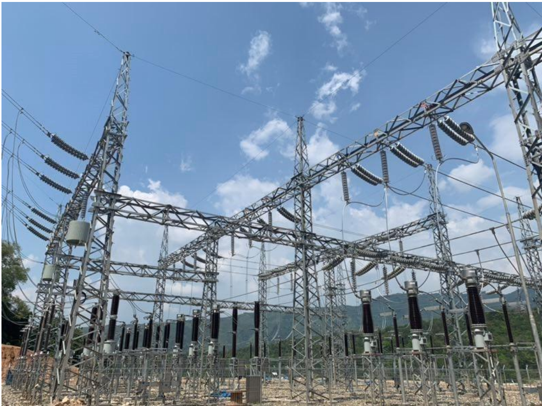
SMGP项目输变电系统
