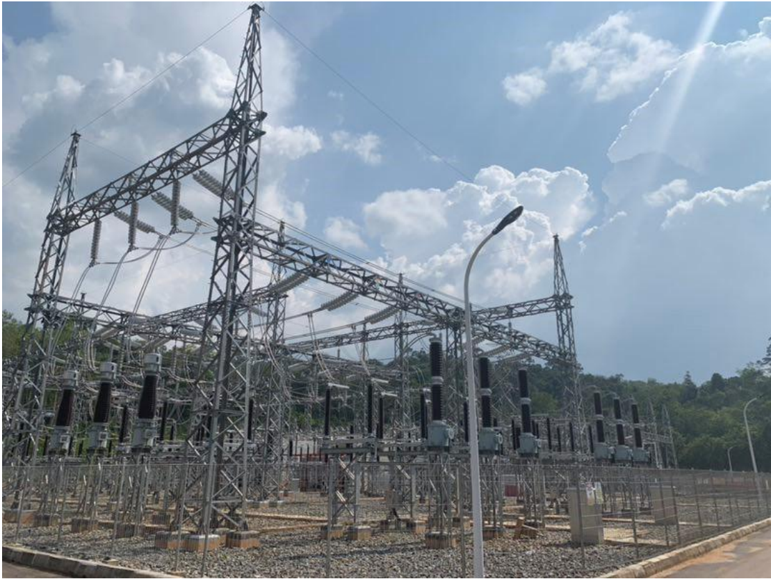
SMGP项目升压站
