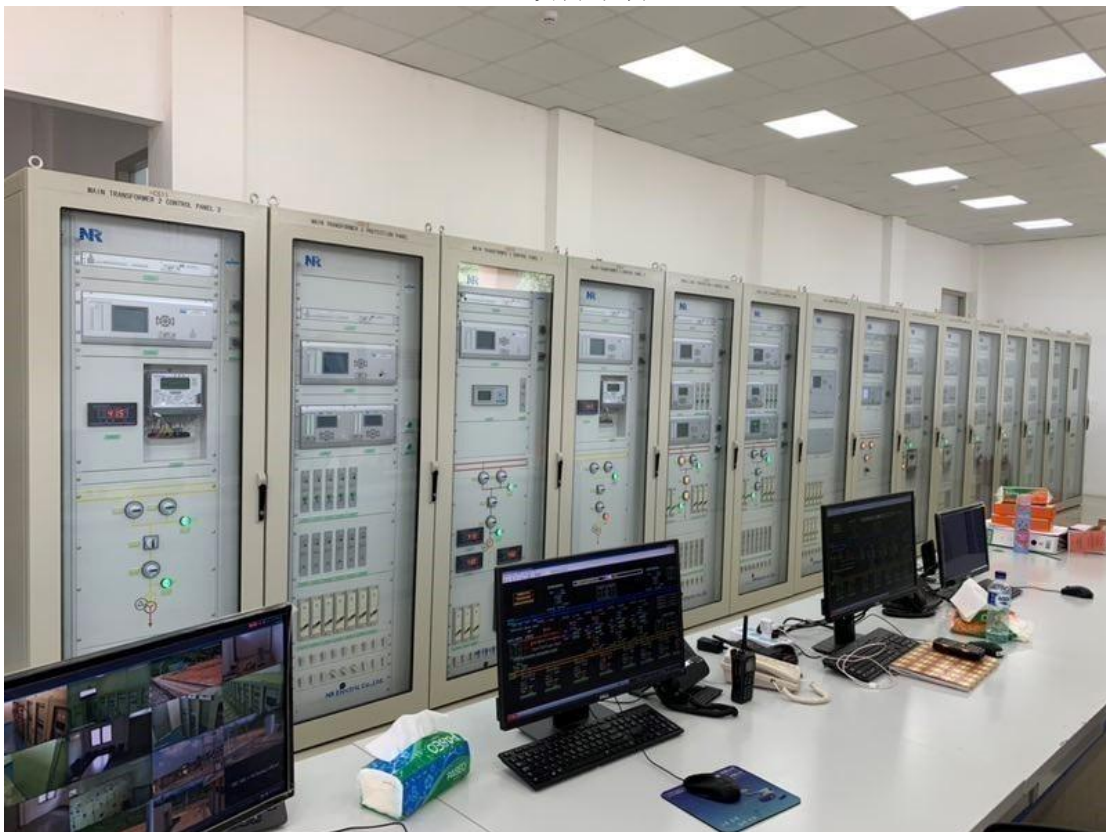
SMGP项目升压站控制室
