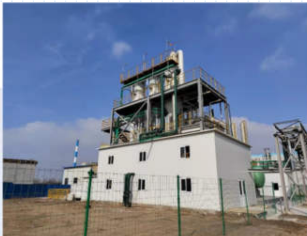
三效蒸发设施
