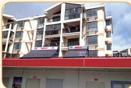
节约型工地—生活区太阳能热水器
