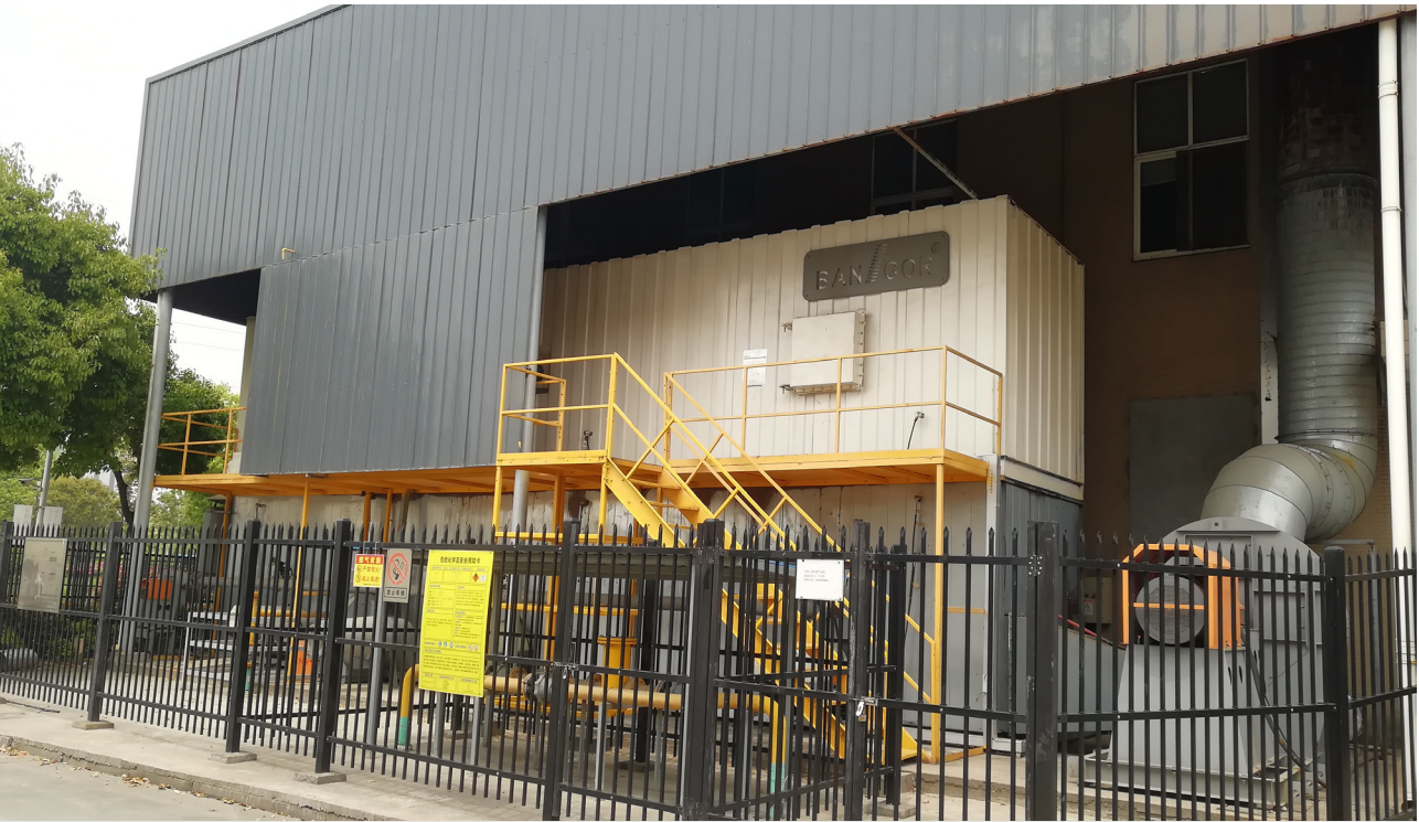
废气处理设施
