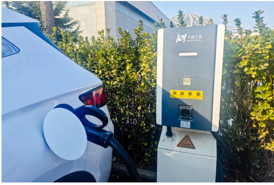
电动车充电桩
