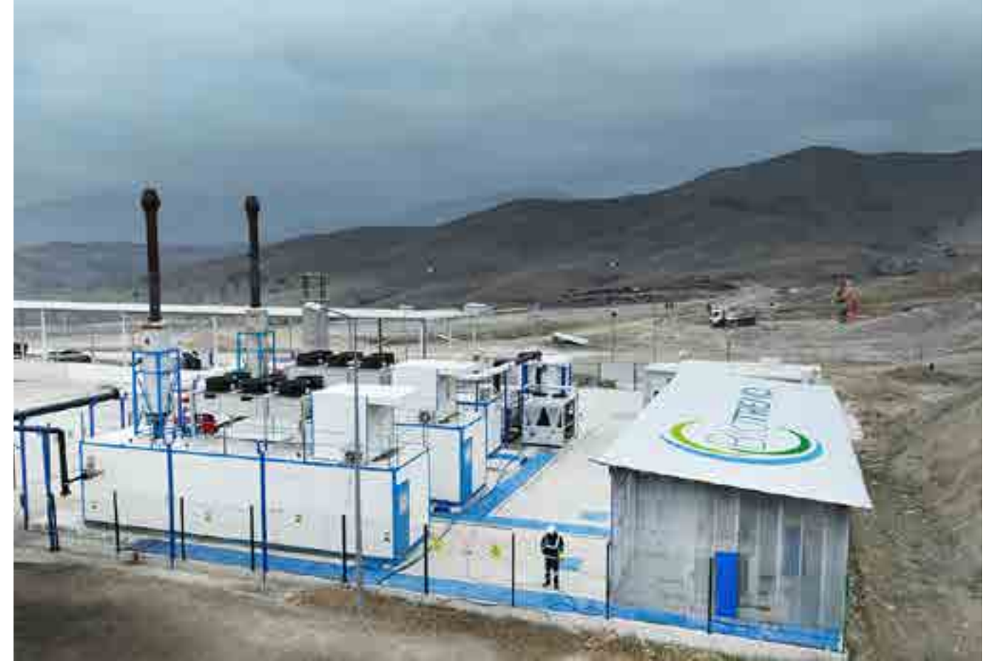
Malatya Büyükşehir Belediyesi Katı Atık Sahası Çöp Gaz Doğu Star Elektrik Üretim A.Ş.
