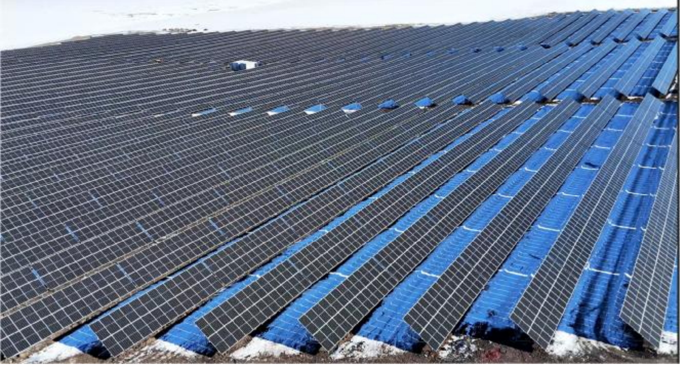
Kars Arazi Güneş Enerjisi Santrali
