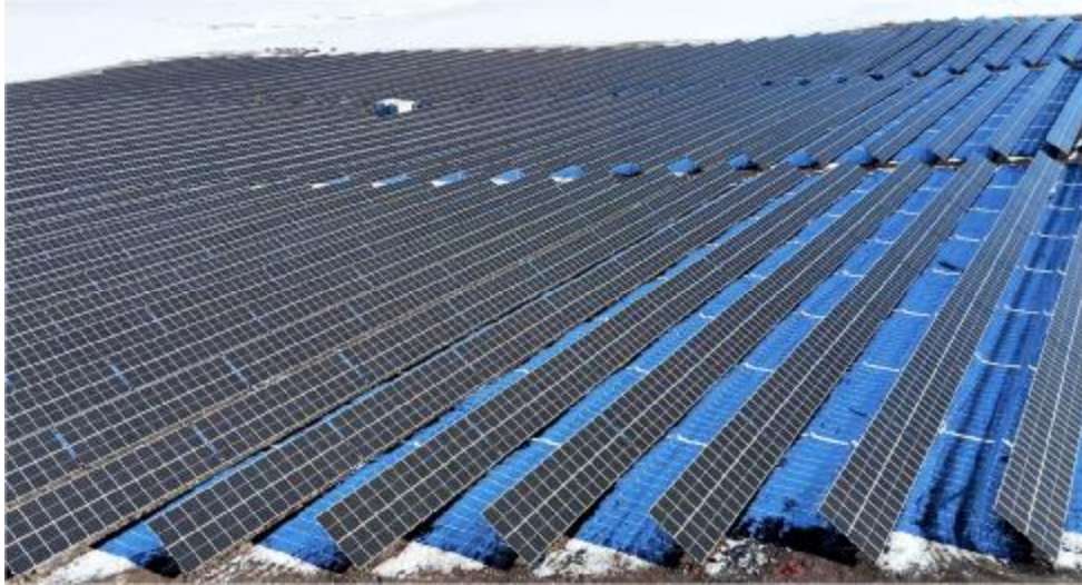
Kars Arazi Güneş Enerjisi Santrali
